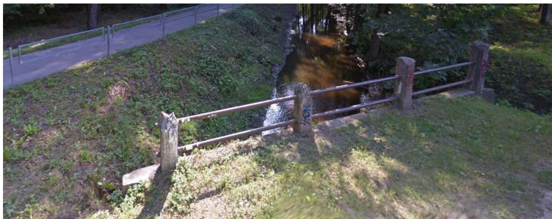
61.att. Esošas norobežojošas betona un metāla barjeras pie Brūkleņu ielas [Avots: autora uzņemta fotogrāfija]
