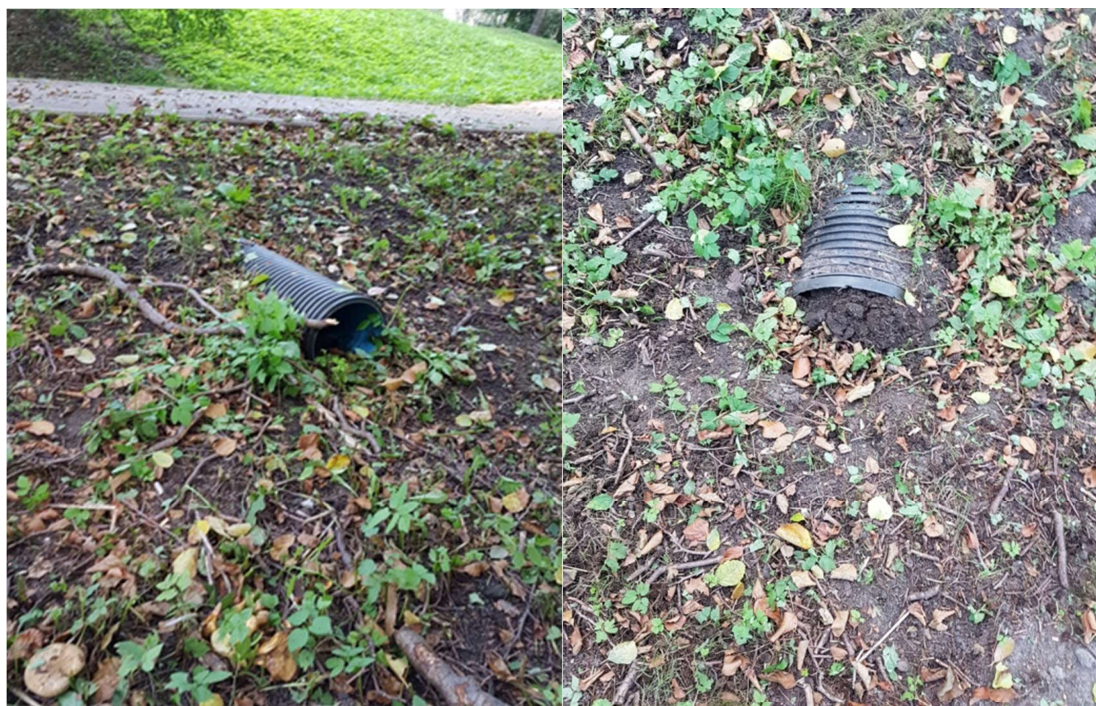
39.,40.att. Esoša daļēji un pilnībā aizbirusi caurteka [Avots: autora uzņemta fotogrāfija]
